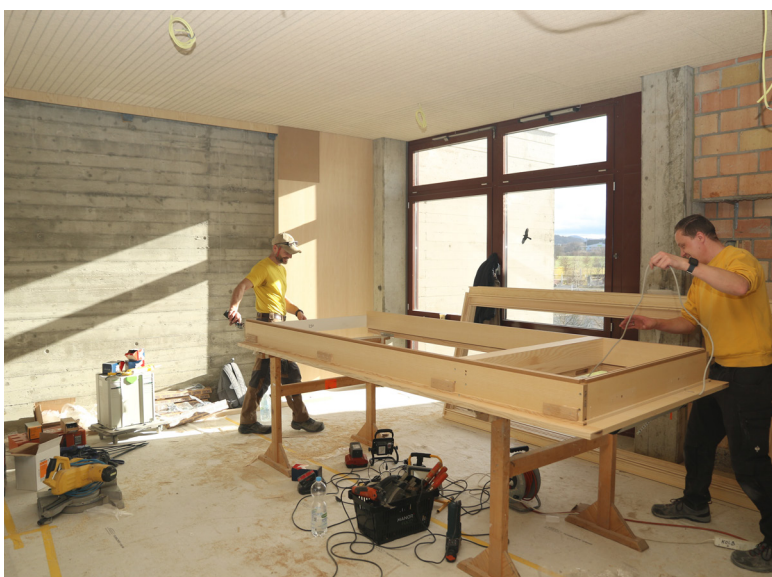
Die Schreiner bereiten die neuen Türrahmen der Klassenzimmer für die Montage vor.
